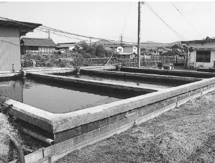
老朽化した甲田給水区施設
