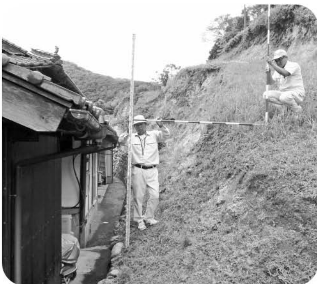
小規模崩壊地
