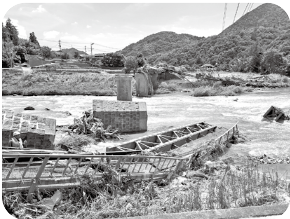
被災した芸備線の鉄橋
