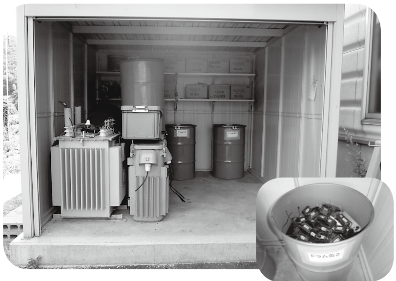
美土里支所で保管しているPCB（有害物質）
