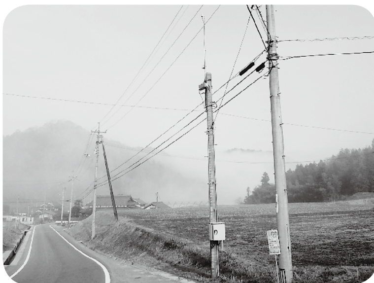
電柱に設置の無線機器（吉田町小山）
