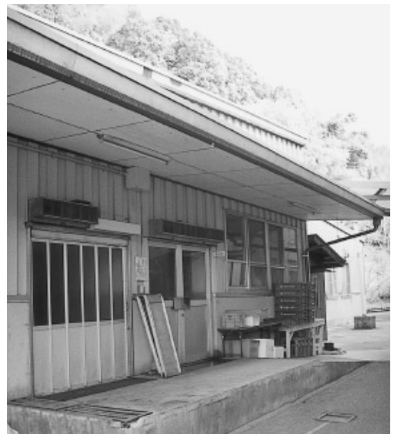
老朽化が進む給食センター
