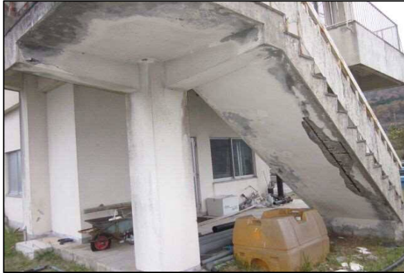
管理棟 躯体のひび割れ
