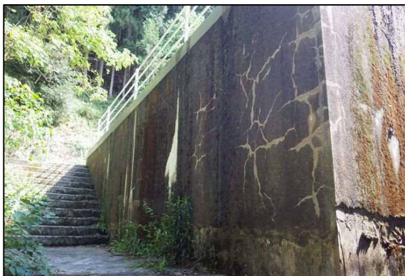
国司1号配水池 躯体のひび割れ
