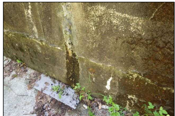
国司1号配水池 ひび割れからの漏水
