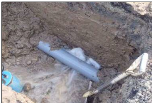
老朽管路 (非耐震管)
