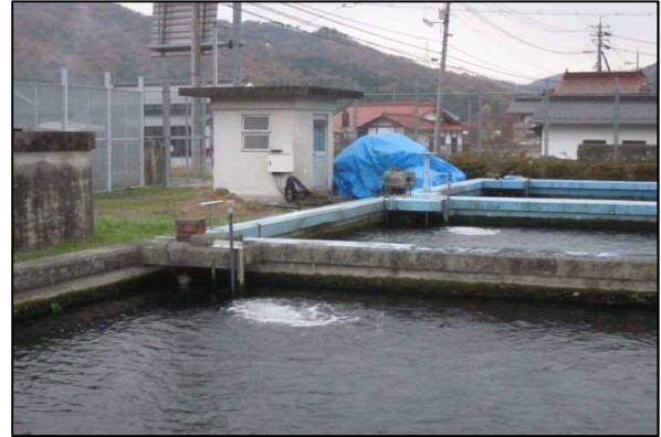
ろ過池 躯体の劣化
