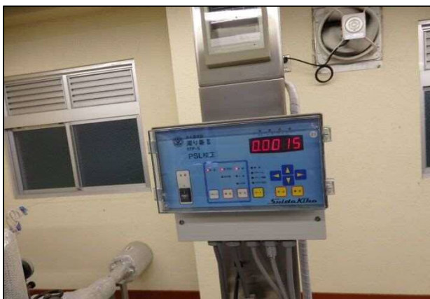
坂上浄水場 濁度計
