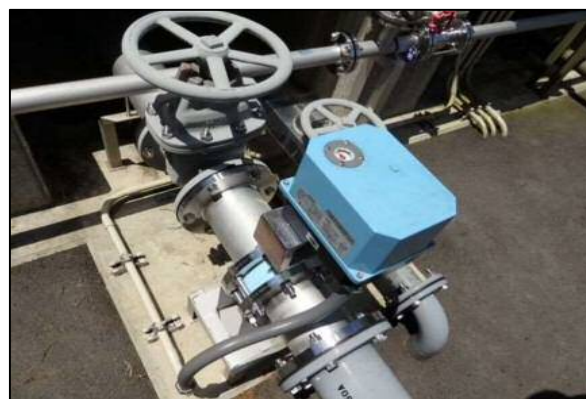
横田第2配水池 (丹比・可愛地区)
