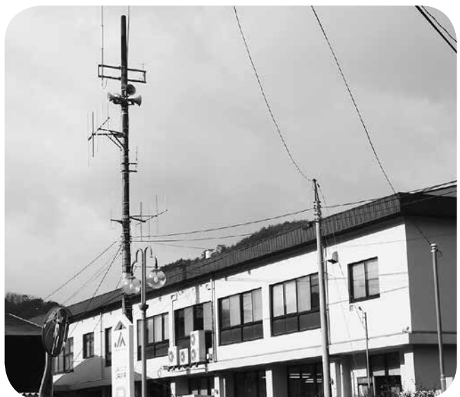
防災無線として活用していた屋外スピーカー
