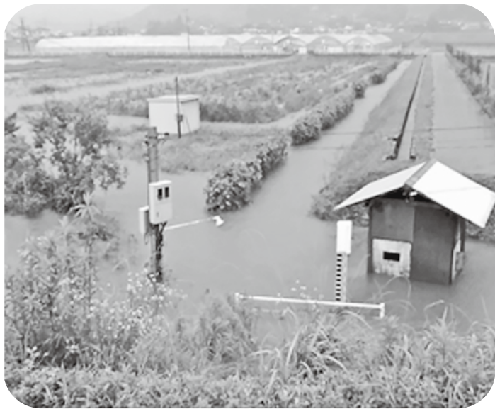
西日本豪雨時の浸水箇所
