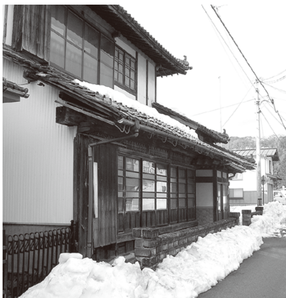
屋根からの危険性(瓦の落下等)が考えられる道路に面した空き家
