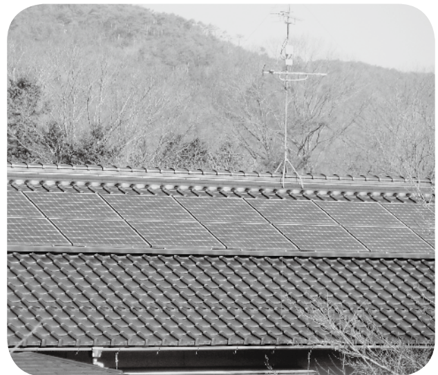
環境にやさしい住宅用太陽光パネル
