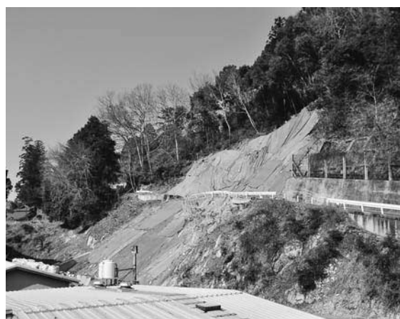
吉田高校裏山崩落現場。 （撮影：H23年2月4日）
